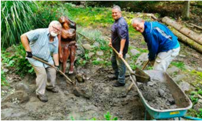
Ein Anfang ist gemacht: Die Unwetterschäden am Mühlenweg werden auch in Zukunft noch einen immensen Arbeits-einsatz erfordern. Wir sind bereit!
